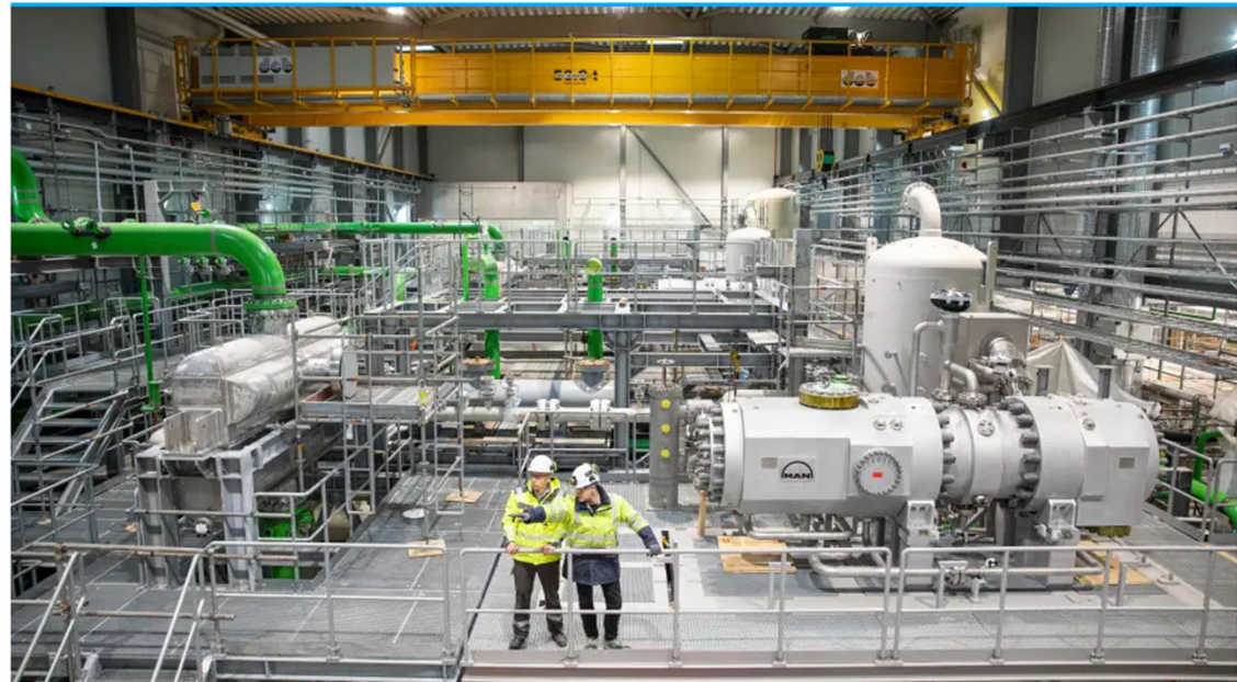
Die Großwärmepumpe von MAN Energy Solutions in Esbjerg in Dänemark versorgt 100.000 Menschen mit Wärme.
